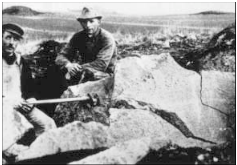
Fig. 11. De store sten i stengravene har været velegnede til mange anlægsarbejder, bl.a. som fundamenter i kirker og herregårde, men især anlæggelsen af de mange nye veje i 1800-tallet var hård ved stengravene. Her er man i færd med at hugge en jættestue ved St. Lyngby ved Arresø til skærver. Foto fra mellem 1910 og 1920, tilhører Skævinge Historiske Forening, gengivet fra F. Kaul: Dysser og Jættestuer i Horns Herred . Udgivet af Historisk Forening i Jægerspris Kommune 1987.
